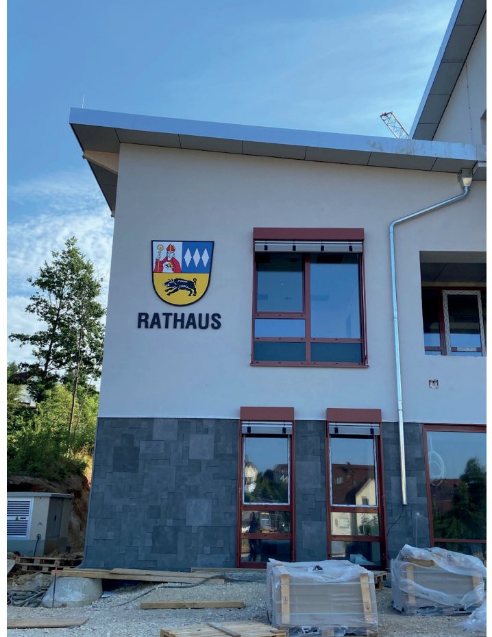
Das neue Rathaus ist außen bereits fertiggestellt und wird derzeit im Innenausbau vollendet. © Gemeinde
